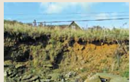
Érosion sur une route au bord de la mer.
